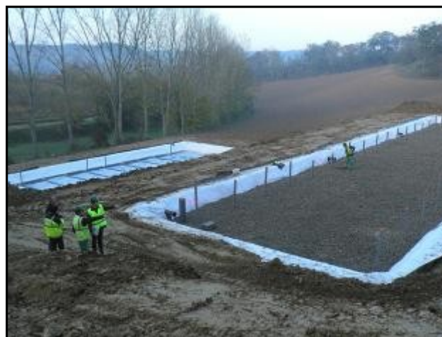
Station d'épuration composée de deux bassins
