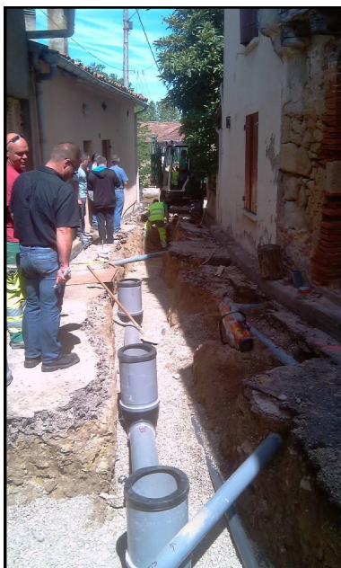
Passage des réseaux Rue du Vinaigre
